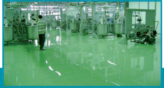
ROMPOX® 1107 ESD-покрытие в производственной зоне для смешивания краски • ROMPOX® 1107 ESD coating in production area for paint mixing • ROMPOX® 1107 ESD-Beschichtung im Produktionsbereich für Farbmischung
